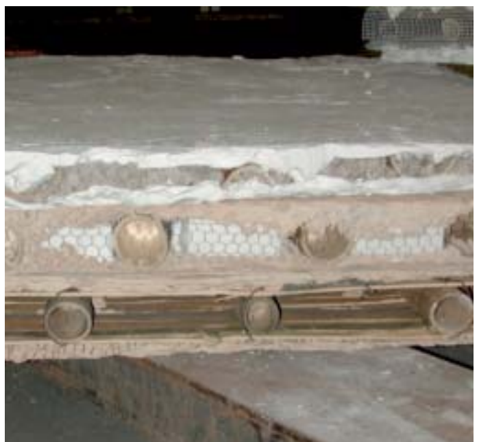
Bild 3: Eine Deckenkonstruktion im Iran. Aus Bambus, Drahtgewebe, Gips und Dämmstoff werden leichte, duktile und ausreichend standfeste Tragstrukturen für erdbebengefährdete Gebiete im Iran hergestellt. [5]
