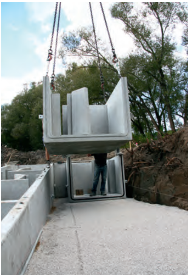
Der erste österreichische Fishpass ist fertig montiert und für den Praxiseinsatz bereit.
