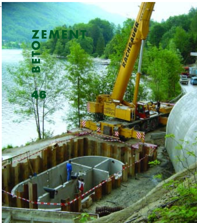
Gewässerschutzanlage zum Rückhalt und zur Reinigung der Tunnelabwässer
