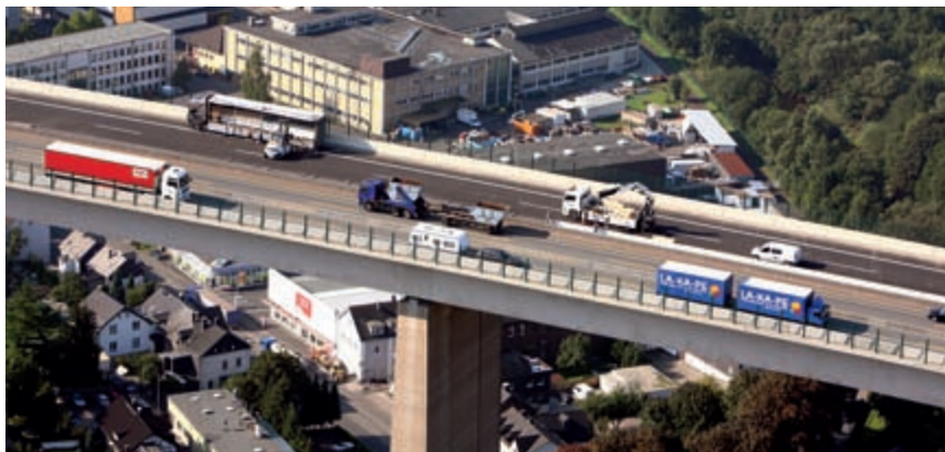
Installation Siegtalbrücke, DB 80AS-R als 2-fache Mittelabsicherung , DB100 AS-R Randabsicherung
