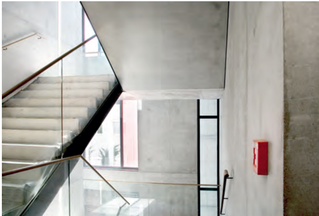
Vom Treppenlauf bis zu den Wänden und Untersichten besteht alles aus Sichtbeton.
