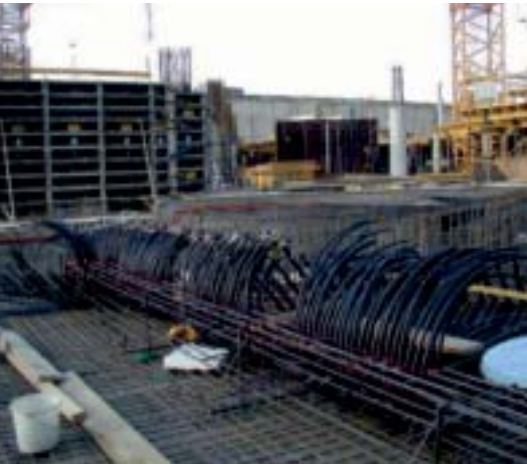
Bild 6: Zusammenfassung der in Summe 800 Kreise, der Pfähle und der Fundamentplatte sowie Ausmündung in den später errichteten Verteiler der Zentrale der Wärmepumpenanlage © Strabag
