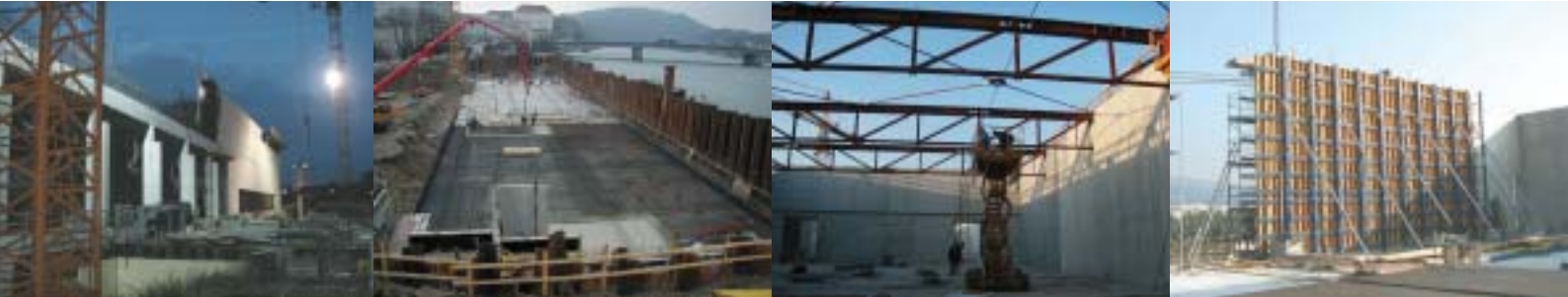
Fotos v.l.n.r.: Bauzustand bei Nacht, Baugrube mit Hochwasser, Stahlfachwerke im Obergeschoss, Sonderschalung Wand
