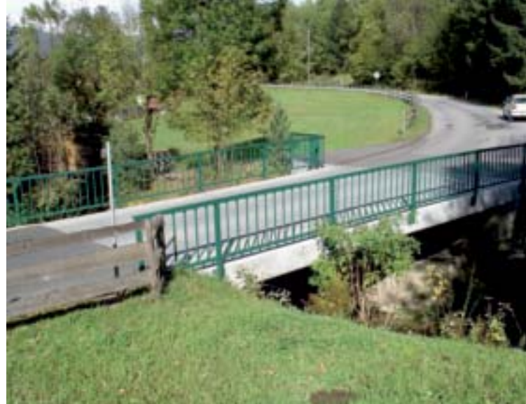
Bild 12: Landfraßbrücke – Brückengeländer seitlich montiert, keine Randbalken
