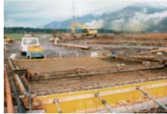
Bild 7: Stabile C-Profile wurden als Führungsschienen an den Verdübelungsbügeln lage- und höhenmäßig angeschweißt.
