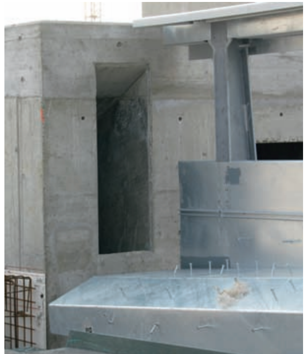
Kabeleinleitung in Kollektortragwerke
