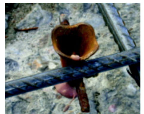
Bild 7: Tiefere Lage der Bewehrungslage auf einem Montagestab
