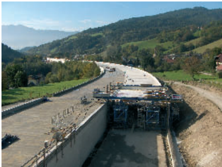
Abb. 4: Einhausung Trebesing mit einer Länge von 848 m
