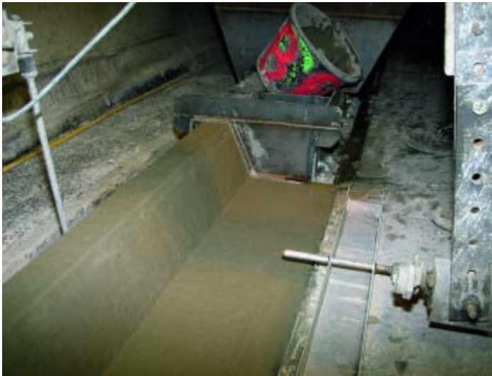
Herstellen des Bordsteins in Gleittechnik Fotos: Ing. Markus Luger, Amt der Vorarlberger Landesregierung
