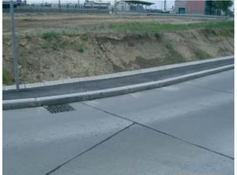
Querrisse an 10 bis 12 Jahre alten Betondecken an hochbelasteten Straßen
