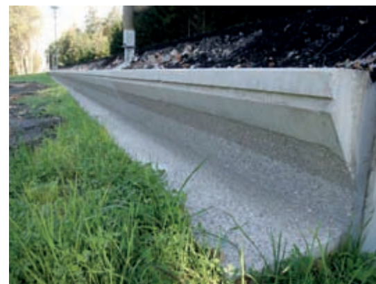
Bild 5: Überkletterungsschutz Alle Fotos: © Rieder
