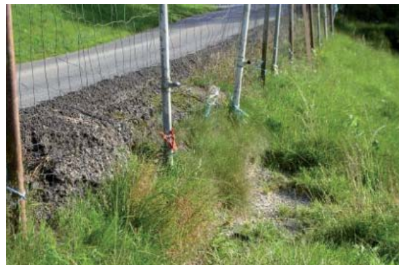
Bisherige Sanierung der Absetzungen durch Aufkeilung des talseitigen Randes mit Profilmischgut, Stärke insgesamt bis zu 80 cm
