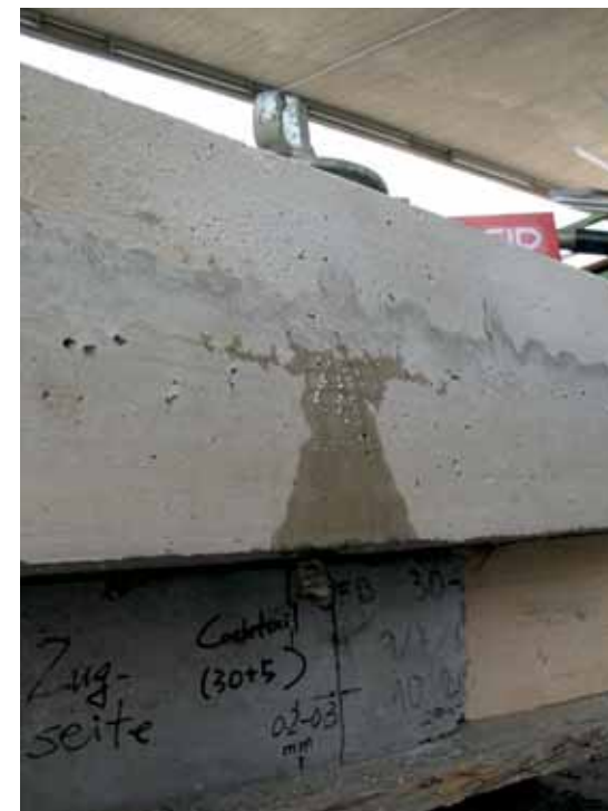
Abb. 3: Wasseraustritt zwischen Außen- und Innenschale
