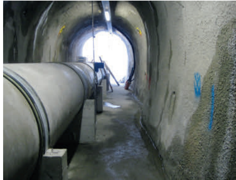
Triebwasserleitung auf Betonsockel nach Entsander
