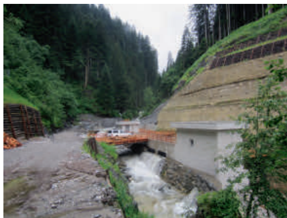
Wasserfassung und Entsanderanlage in Betrieb
