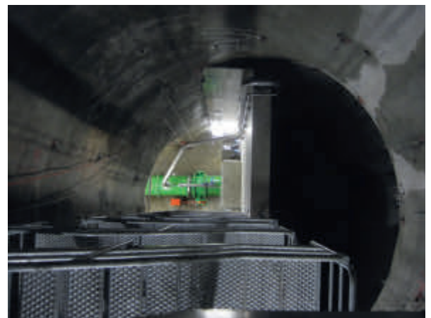
Wasserschlossschacht, Rohrbruchklappe rechts, Schwallkammer links
