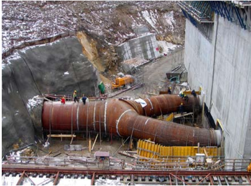
Maschinenhaus mit Verteilerrohr
