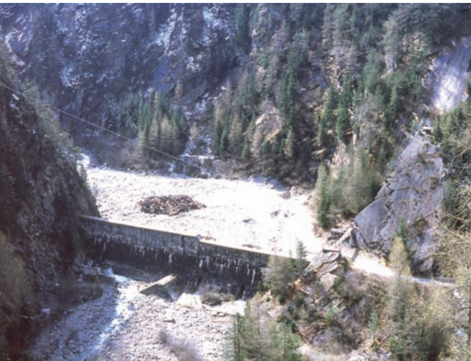
Abb. 1: Fischbachsperre mit Überlaufkanal
