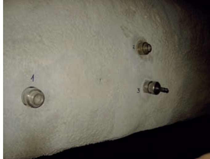
Bild 7: Prüfung Haftzugfestigkeit LT 23
