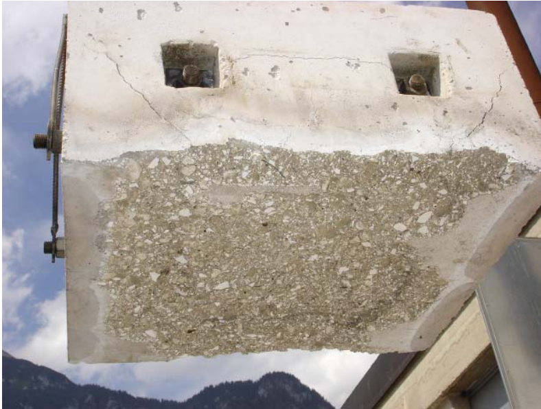
Bild 3: Deutliche Abplatzungen am 0-Beton und am LP-Beton ohne Fasern (11 % Luft)
