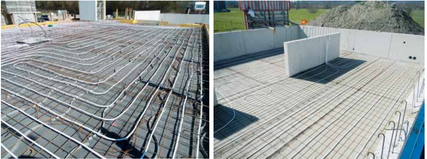
Leitungen in der Bodenplatte bzw. im Erdspeicher – Wärmeenergie wird ohne Wärmetauscher direkt in den Betonkern geleitet und gespeichert.
