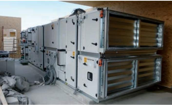
Bild 4: Technikzentrale im Dachgeschoss, DEC-Anlage
