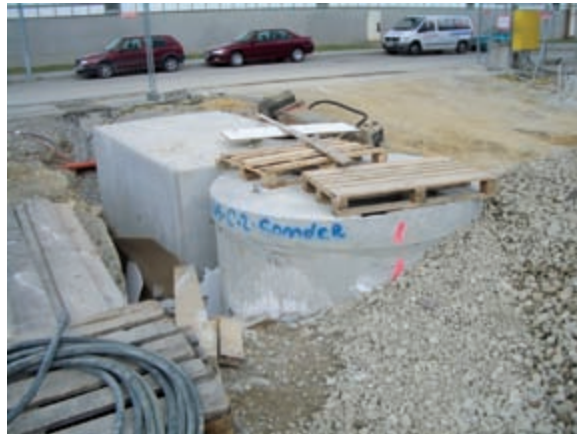
Bild 5: Grundwasserbrunnen im Vorplatzbereich
