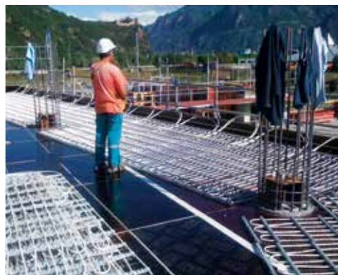
Oberflächennahe Betonkernaktivierung im Randbereich
