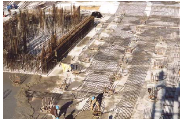
Abb. 5: Absorberleitungen einer „Energiebodenplatte“
