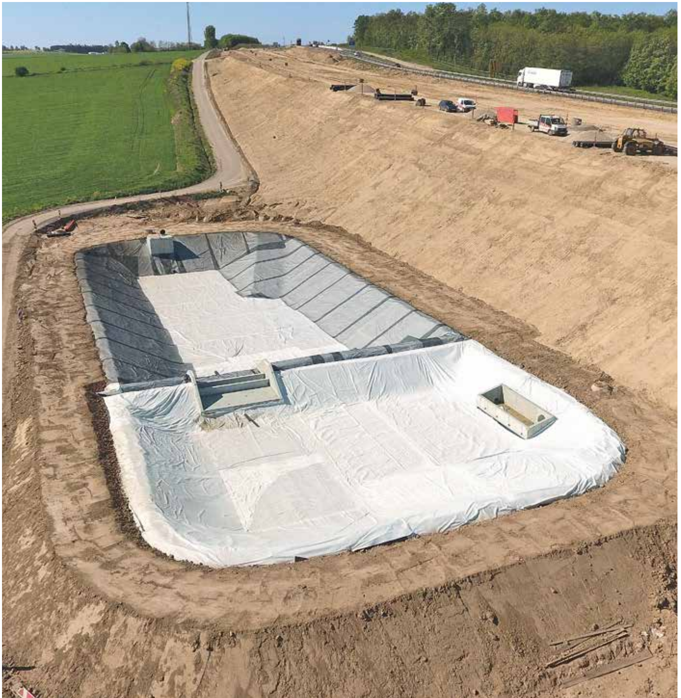
Über die gesamte Trasse sind 18 Gewässerschutzanlagen realisiert, die durch ein Monitoring überwacht werden. Hier eine Gewässerschutzanlage mit zweistufigem Becken.
