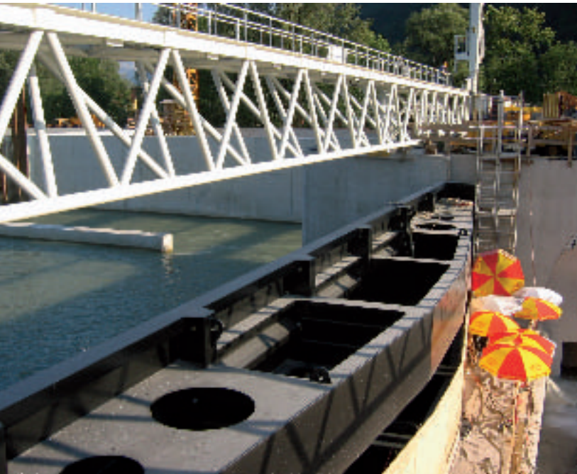
Wehrfeld 2 mit Oberwasserdambalken und Oberwasserportalkranträger vor der Klapfenmontage und nach Einbau einer Hartbetonschicht. Die Beschattung durch Sonnenschirme diente der Schwindminimierung des Polymerebetons vor dem Anschlussblech der Wehrklappe.
