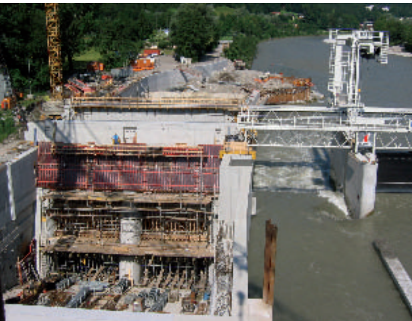
Blick auf den Krafthauseinlauf (spätere Rechenebene) und Wehrfeld 1 (Spülgasse). Eine 10 m breite Spülgasse (hier vor Einbau des Wehrsegments) sorgt im 1. Wehrfeld für den Geschiebeabtransport von der Einlaufschwelle ins Unterwasser. Eine oberwasserseitige Trennrippe soll den Zug im Bereich der Einlaufschwelle erhöhen.
