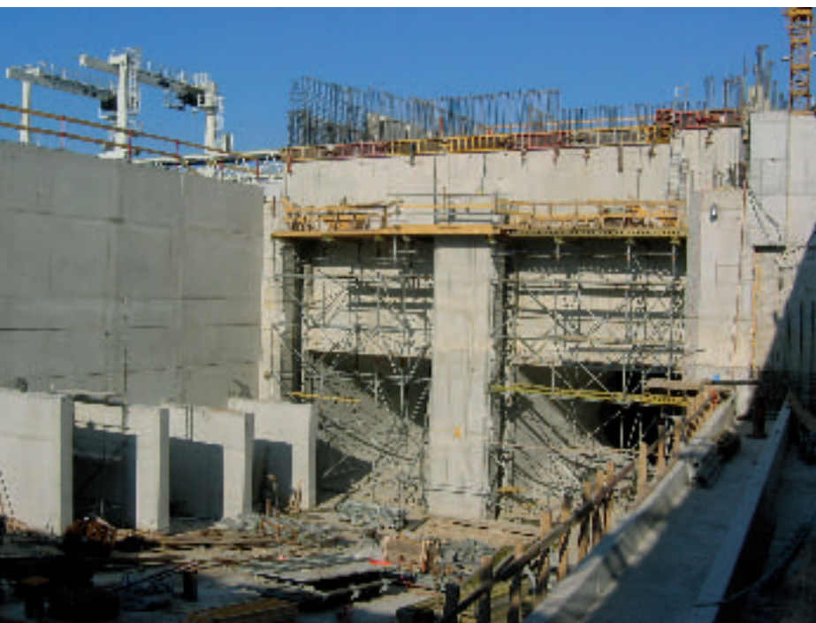
Die links sichtbaren vier Betonscheiben dienen zur Stützung der Trennwand (maßgeblich Lastfall Hochwasser Bauzustand) zum Unterwasserbereich der Wehranlage. Diese temporären Abstützungen werden in der Niederwasserperiode vor Flutung des Auslaufs entfernt.
