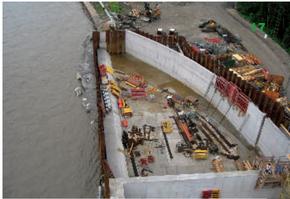
Die Einlaufschwelle wurde hinter einer unverankerten Spundwand hergestellt. Um dies zu ermöglichen, musste ab einem bestimmten Wasserspiegel der Einlauf teilweise geflutet werden. Hinter der landseitigen Einlaufwand erkennt man die Spundwandumschließung des Fischeaufstiegsbauwerks (vertical slots). Foto: © Christoph Schenk, Salzburg AG
