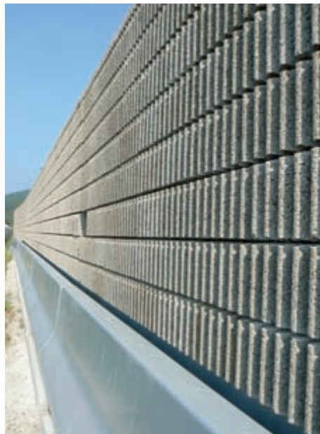
Abb. 4: Auf der Baustelle werden Lärmschutzwand und Leitwand zu einer platzsparenden Einheit verbunden.
