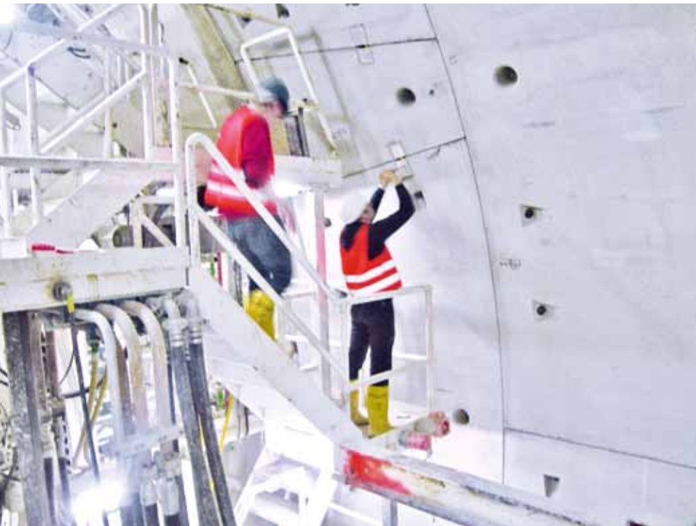
Hinteres Ende der TBM als Arbeitsplattform
