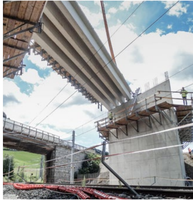
Spektakulär: Oben Straße – unten Schiene. Die Anlieferung der Betonfertigteilträger verlangt eine penible Planung, Know-how und Erfahrung.
