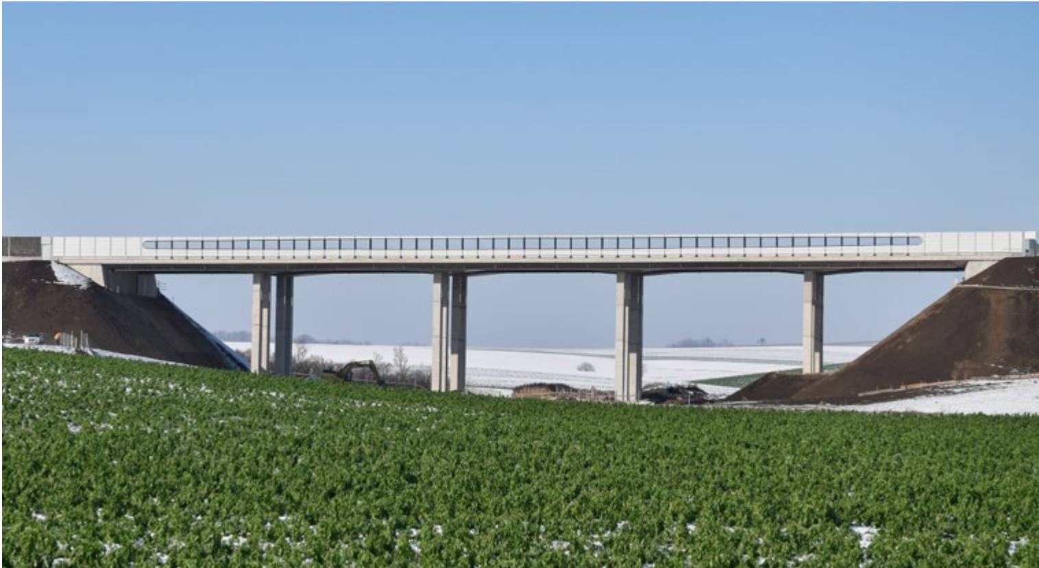
Neu und spektakulär: Die Brücke, die sich dehnen kann – über den Satzengraben auf der A5, bereits im bewährten Einsatz.
