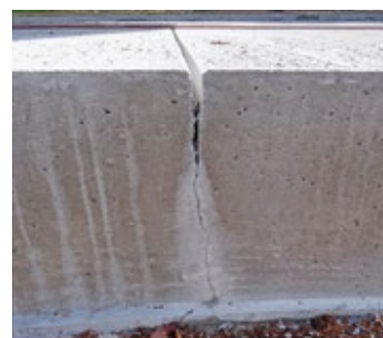
Technisch notwendiger Kontraktionsriss an der Scheinfuge in der Fahrbahnplatte
