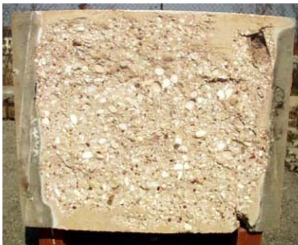
Abbildung 1-1: Oberfläche von M1 (ohne PP-Fasern) nach dem Brandversuch
