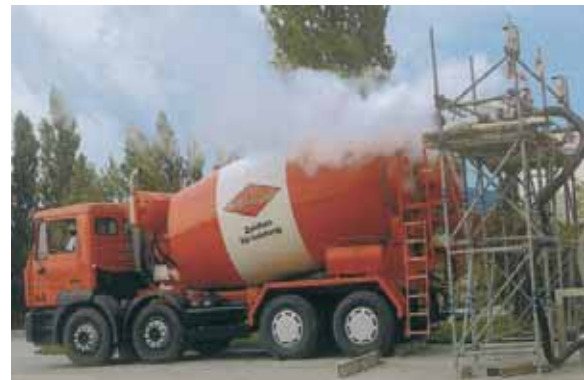
Bild 5: Ausführungsbeispiel Kühlung mit flüssigem Stickstoff
