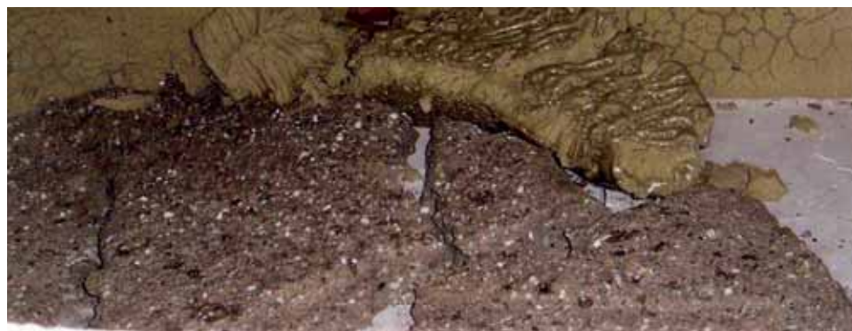
Bild 8: Im Bildvordergrund am Boden liegender, abgefallener Spritzbeton, 20 Minuten nach Brandende
