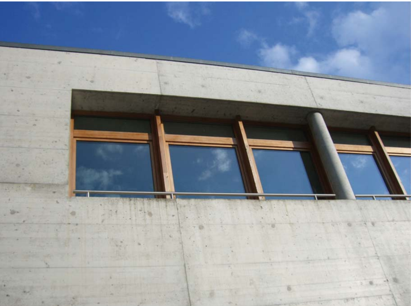
Abb. 3: Beispiel zur Klassifikation der Farbgleichheit nach [3] – Betonoberfläche bereits durch Witterungseinflüsse beaufschlagt. Farbgleichheit Klasse F2 (beurteilt ca. 6 Monate nach Fertigstellung)
