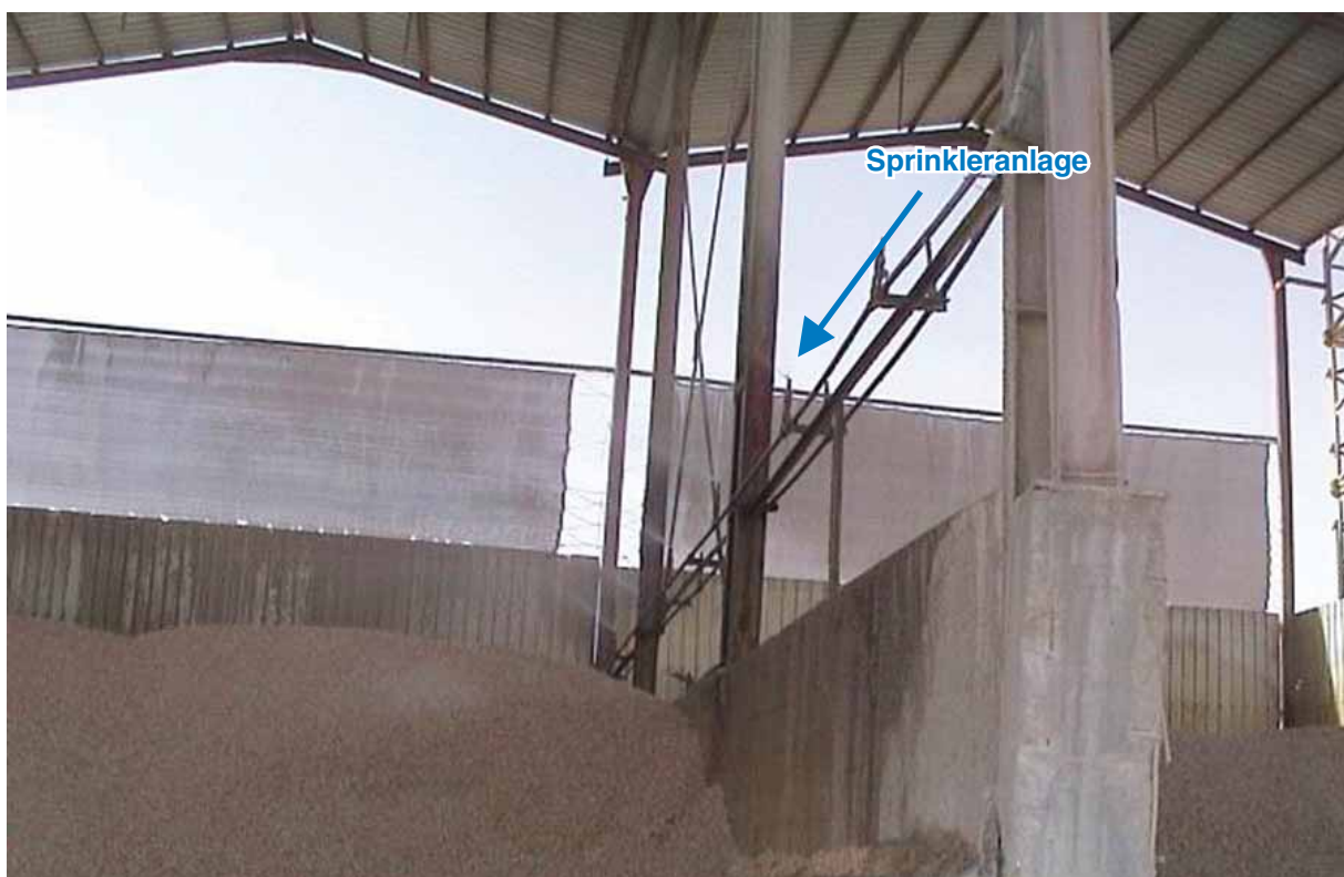
Sprinkleranlage zur Kühlung des Zuschlagstoffes
