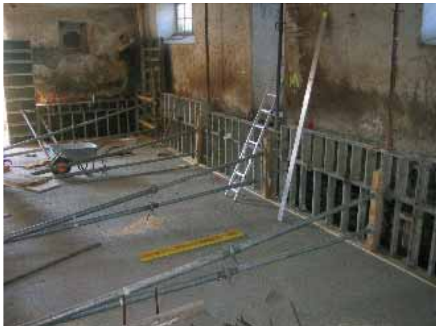
Schalung zur Betonierung der Auflager für den Spaltenboden im Randbereich Fotos: © F. Petscharnig
